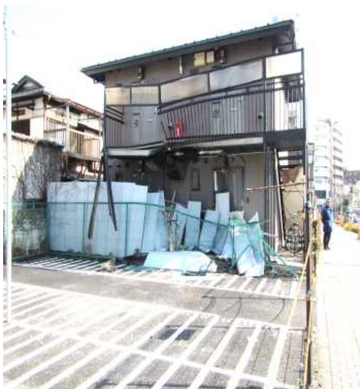
写真 10 当該車両が衝突したアパート
